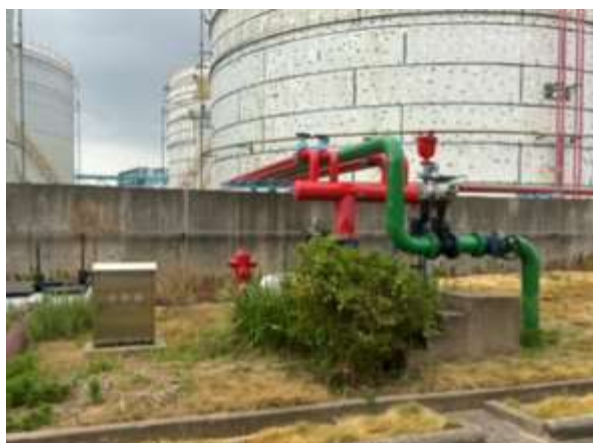
消防水箱、管路
