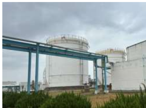
架空污水管网
